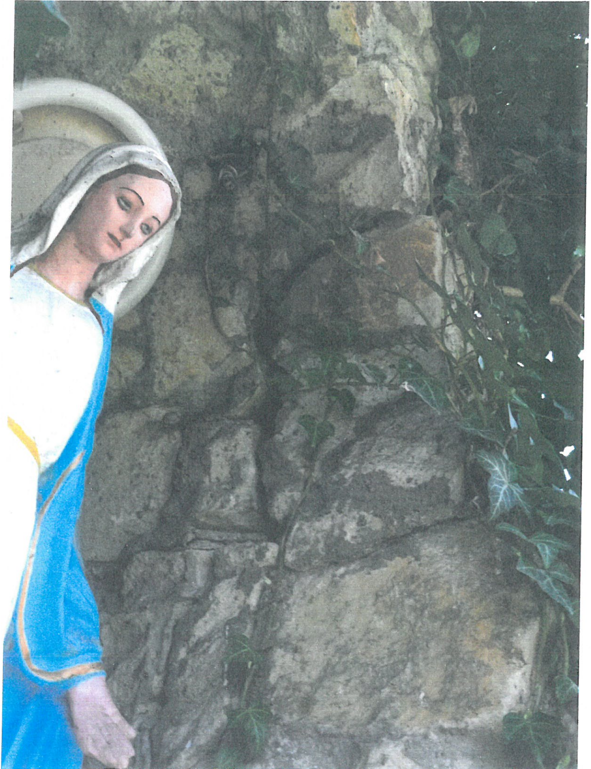
Fot. 9. Kapliczka w formie groty na wzgórzu zamkowym w Dobczycach, umieszczona na lipie „Marysieńka”. Widok na pęknięcia i wykruszenia spoin. Fot. M. Książek 2019.
