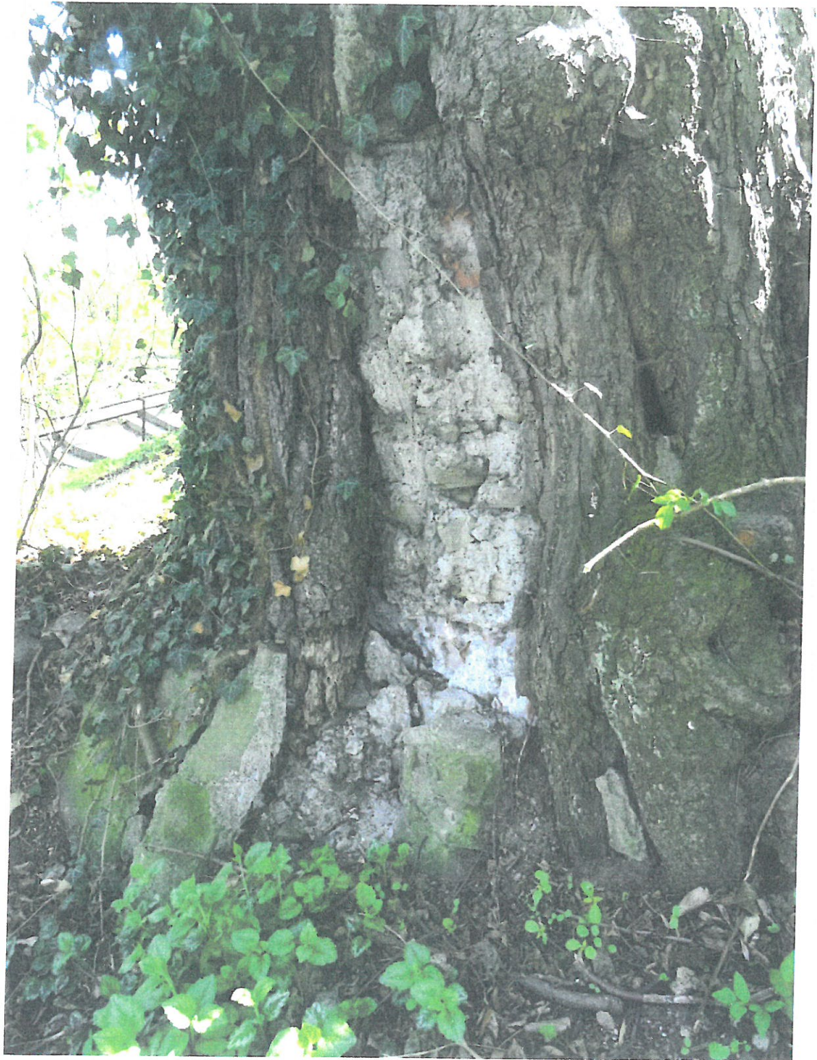
Fot. 8. Kapliczka w formie groty na wzgórzu zamkowym w Dobczycach, umieszczona na lipie „Marysieńka”. Widok na betonowany pień dokładnie widoczne odspojenia dużych fragmentów zaprawy. Fot. M. Książek 2019.
