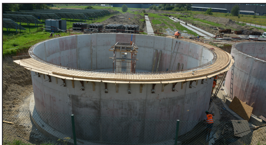
Oczyszczalnia ścieków w Dobzyczach
